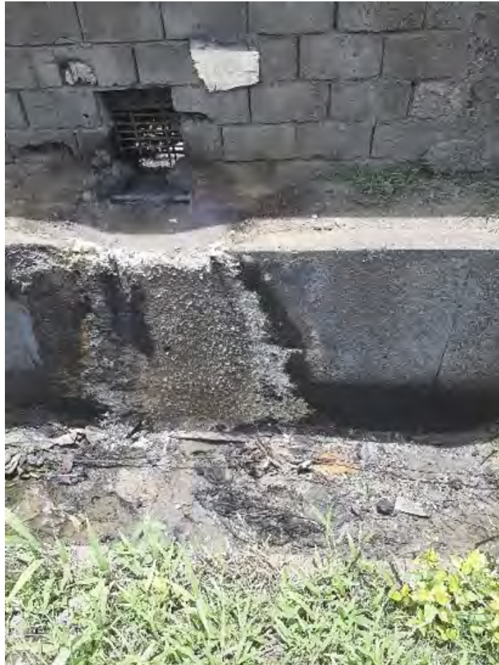
Graphique 4. Effluents non traités rejetés dans une zone habitée adjacente à l'extérieur de METAFRIQUE Cameroon SA. Notez l'effet corrosif de l'effluent acide sur le béton.
