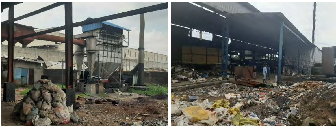
Graphique 5. Filtre à manches à l'usine de recyclage KYSEN (à gauche) et vue partielle de l'usine de GANESHA Cameroon Sarl (à droite).
